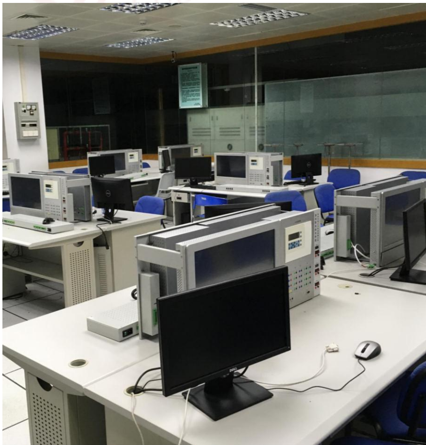
深圳市第二高级技工学校“建筑设备监控实训室”
