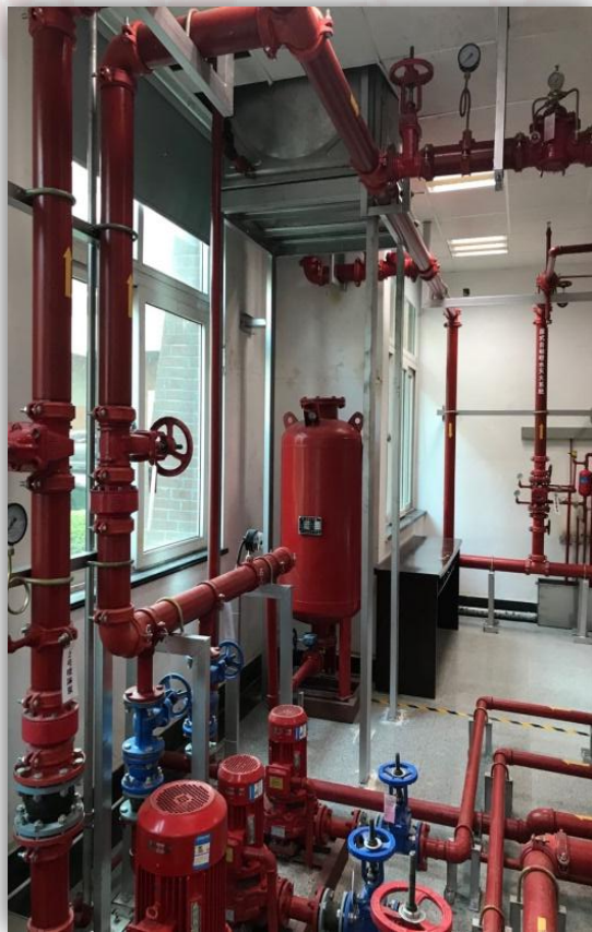
消防喷淋系统
